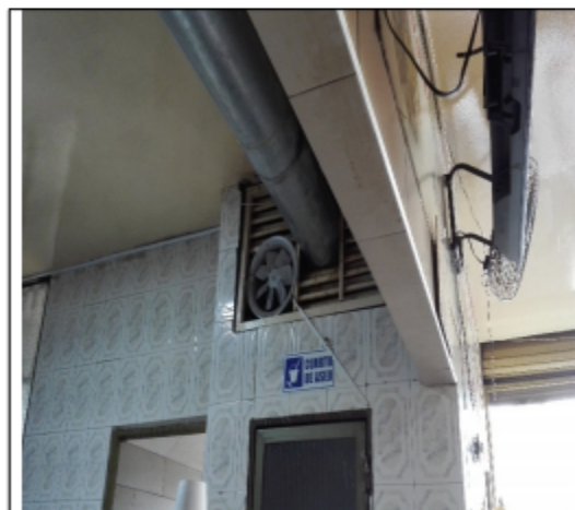
Fotografía No 5. Sistema de extracción
